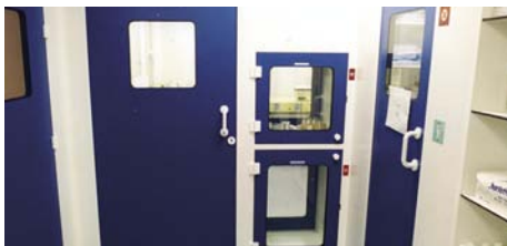
Sas de transfert décontaminable personnel matériel
